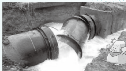
▲老朽管の破損
